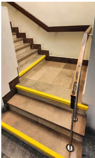
Zdjęcie nr 32: oznaczenie kontrastowe początku i końca biegu schodowego
