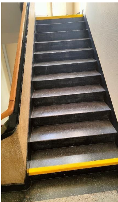
Zdjęcie nr 31: oznaczenie kontrastowe początku i końca biegu schodowego
