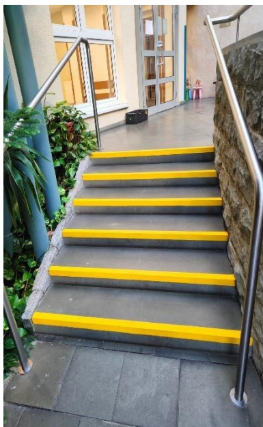
Zdjęcie nr 30: oznaczenie kontrastowe początku i końca biegu schodowego
