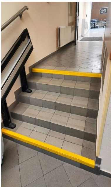
Zdjęcie nr 28: oznaczenie kontrastowe początku i końca biegu schodowego
