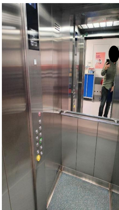
Zdjęcie nr 5: dźwig osobowy kabina
