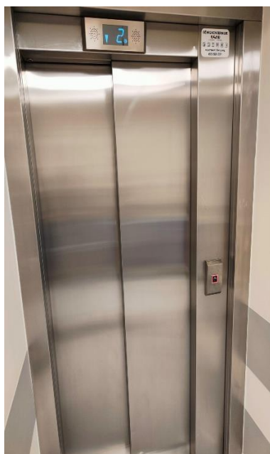
Zdjęcie nr 4: dźwig osobowy wejście
